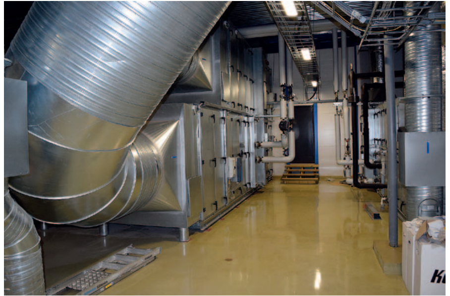
Ilmavaa. Puhallintehtaan konehuone on malliratkaisu teollisuuslaitoksen ilmanvaihdosta. Toteutus tietysti oman pajan koneilla.
